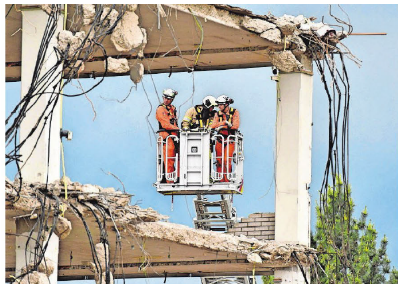
▲ Een deel van het stadhuis stortte vijf jaar geleden in bij sloopwerkzaamheden. [REDACTED]
