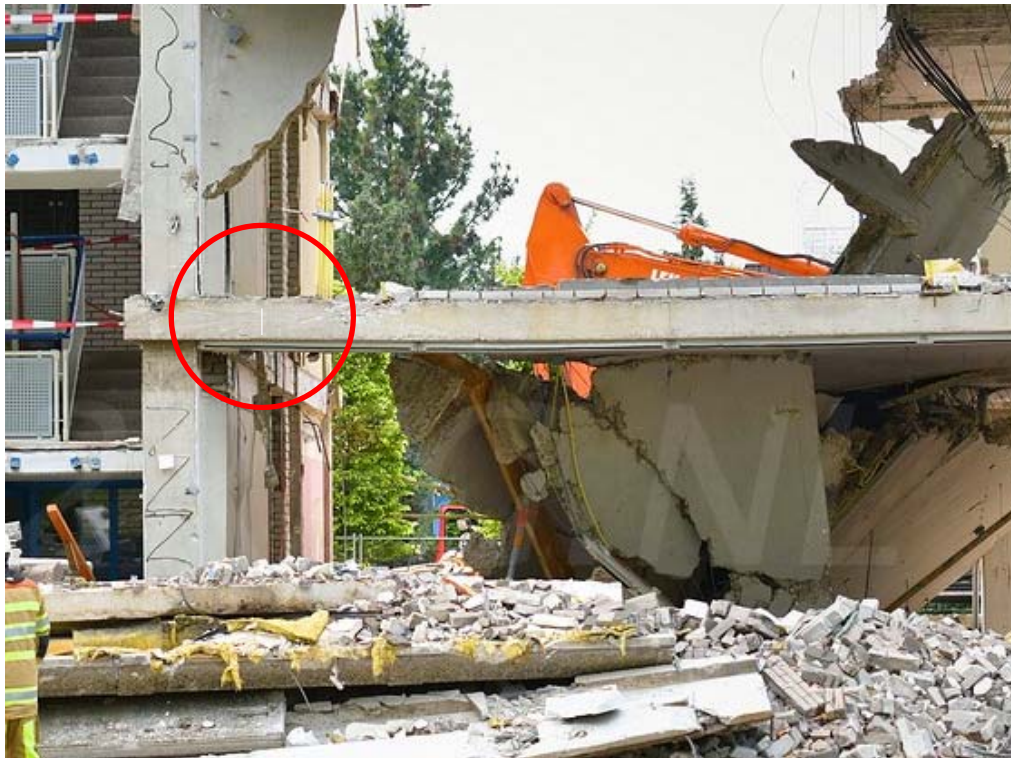
Foto 39: Randstrook 1 e verdiepingvloer niet doorgezaagd (foto: AD).
