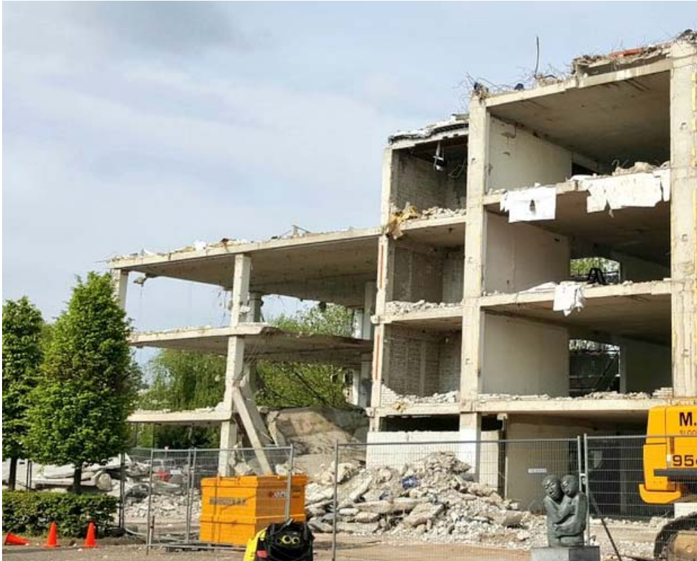
Foto 3: Twee vloeren deels ingestort (foto: AD).
