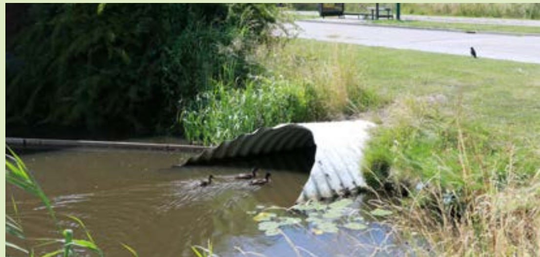
Zichtbare duiker in Snel en Polanen. Veel duikers zitten onder waterniveau door verzakking of omdat er leidingen overheen liggen.
