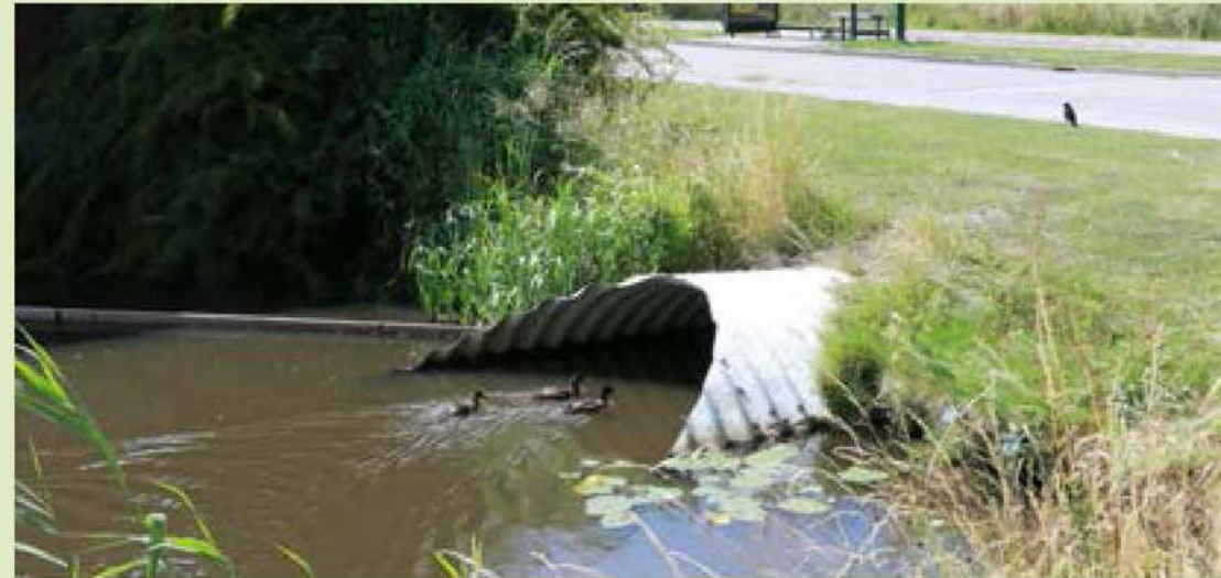
Zichtbare duiker in Snel en Polanen. Veel duikers zitten onder waterniveau door verzakking of omdat er leidingen overheen liggen.
