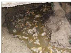
riolen verkeren in een slechte staat
