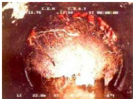
afstroming wordt veelvuldig belemmerd
