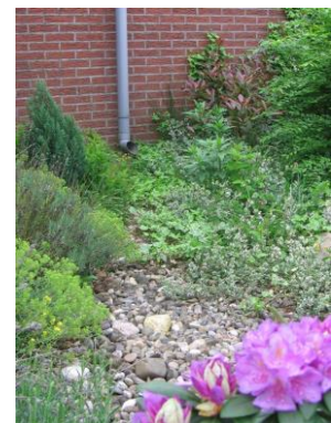
Foto: HDSR, afgekoppelde regenpijp
