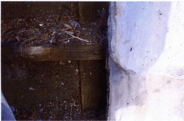
03 De vernageling van de panlatten is door roest aangetast. De panlatten zijn sterk verweerd. (rubriek 2.2.2)
