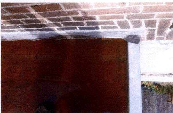
05 Er blijft veel water op het dak staan. Hierdoor is het zink door putcorrosie aangetast. (rubriek 2.2.4.2)
