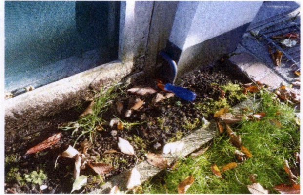
02 Een onderdorpel van het kozijn is door houtrot aangetast. (rubriek 1.4.2)
