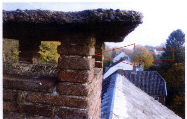
06 Bij de schoorsteen aan de noordzijde staat een van de poeren los. (rubriek 2.6.0)
