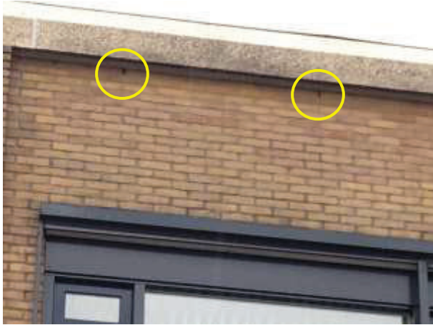
Open stootvoegen vormen potentiële invliegopeningen voor vleermuizen. Deze zijn rondom in het gebouw aanwezig.
