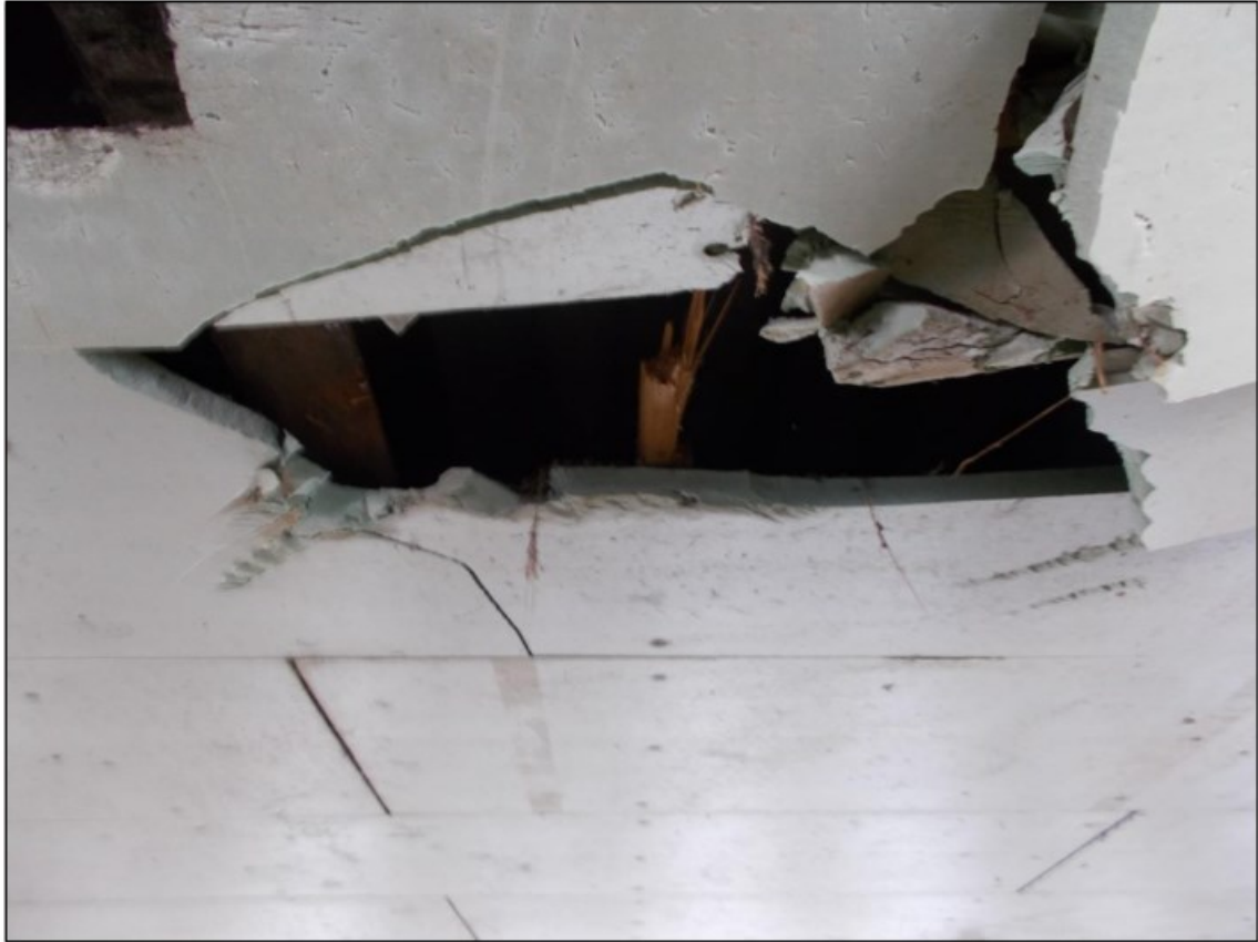
Figuur 9: Gaten in dakbeschot aan binnenzijde schuur.
