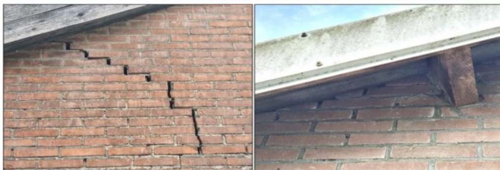
Figuur 6 Delen van de ryholmstal gevel waar specie ontbreekt en waar de aansluiting op het dak kiert.
