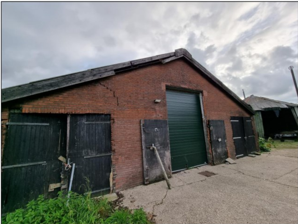
Figuur 4 De gevels van de ryholmstal verkeren in slechte staat en bieden op diverse plaatsen toegang tot de spouw.
