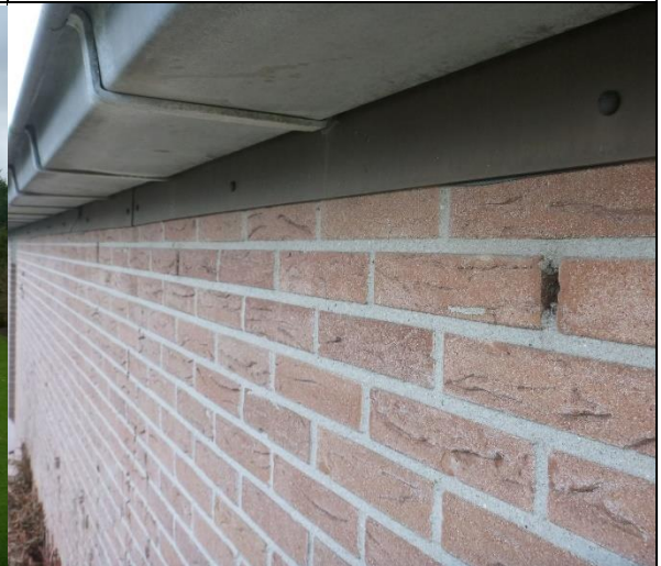
Muur van het woonhuis met open stootvoeg
