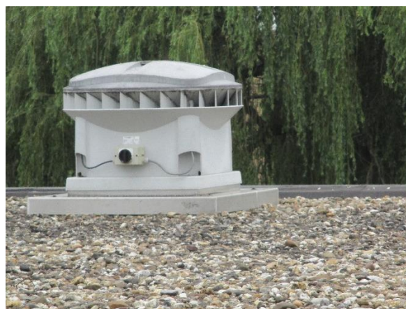
Dakventilator hoge dak
