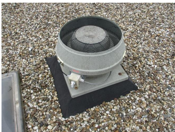
Eén van de twee dakventilatoren lage dak
