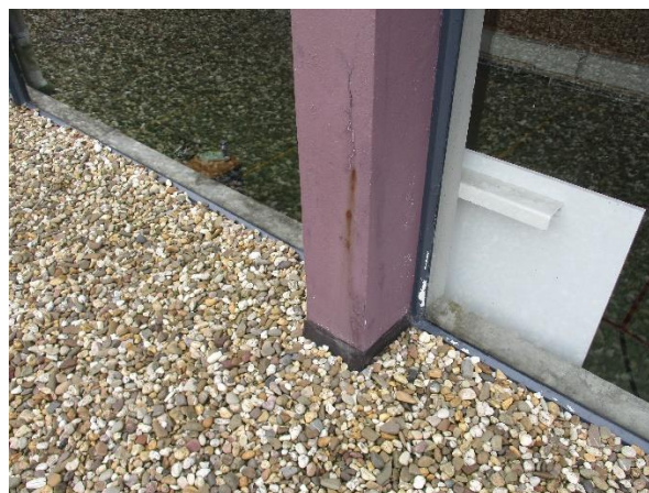
Betonschade kolom hoge voorgevel
