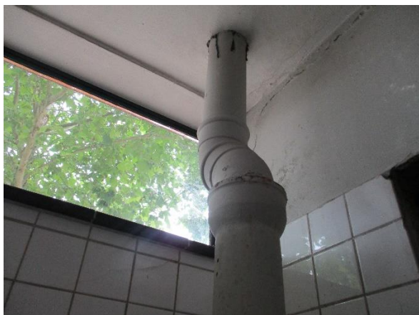
Gietijzeren, inbandige hemelwaterafvoer
