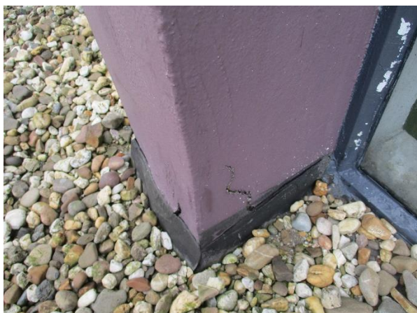
Betonschade kolom hoge voorgevel
